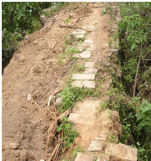
图1 城墙破损状况
